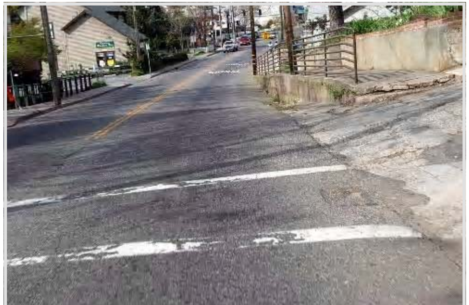
Cette photo est un exemple de passage pour piétons étroit et mal indiqué, situé dans une pente. En outre, il ne semble pas y avoir de refuge adéquat à l'autre extrémité du passage pour piétons. (www.pedbikeimages.org / Dan Burden)
